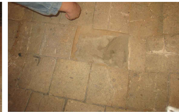
Affaissement du sol
